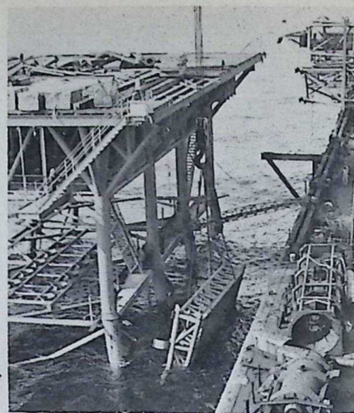
Hier plaatst de „Challenger”-kraan een „boot-landing” tegen een platform, zodat schepen er tegen kunnen meren zonder schade aan de installatie toe te brengen.
