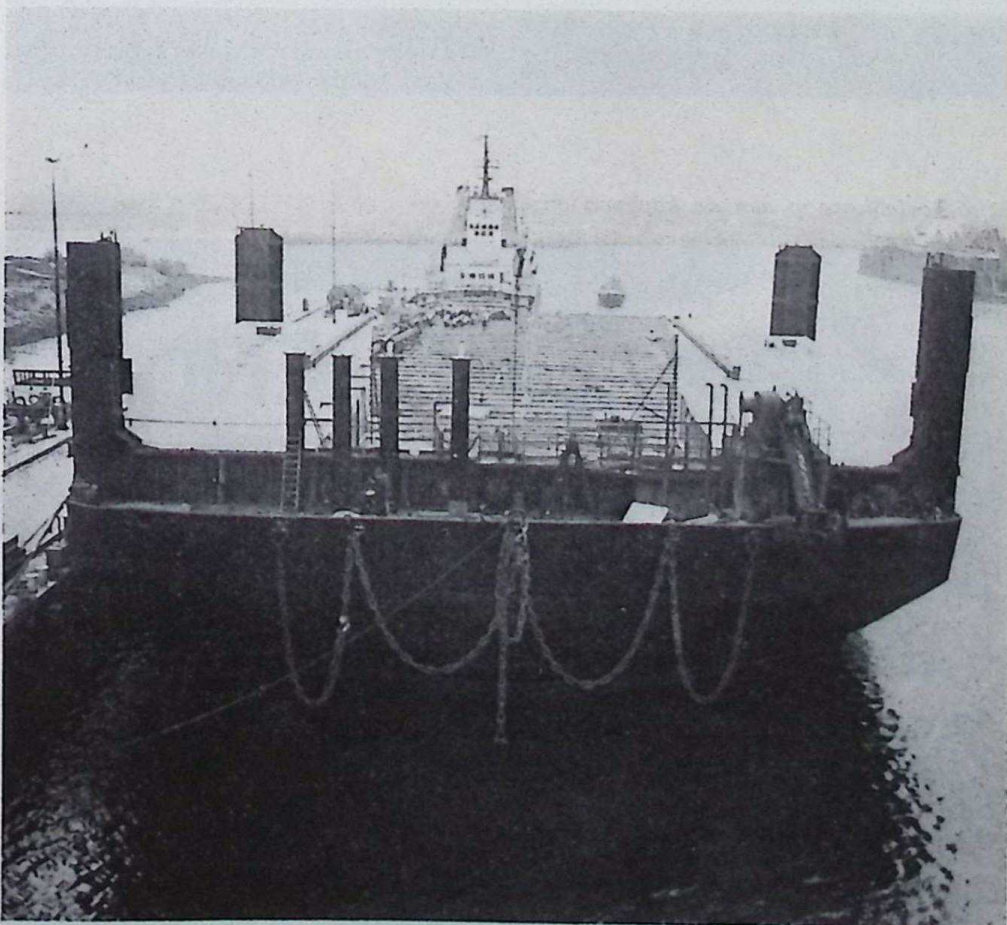
De nog kale „Stevin Express” bij de Jong, Schiedam. De dekhuisen zijn al geplaatst.
