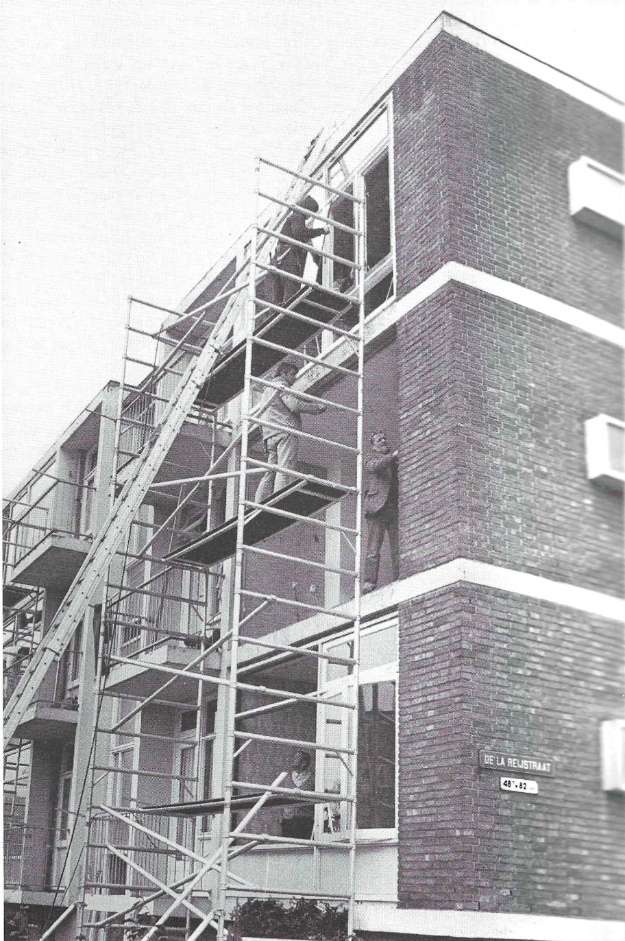
Vernieuwing van gevelpuien in de La Reijstraat met gelijktijdig aanbrengen van isolatieglas.
